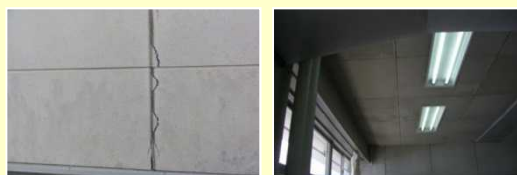
老朽箇所等を総点検し対策を検討
