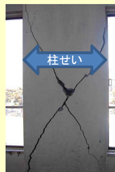
極短柱のせん断破壊
